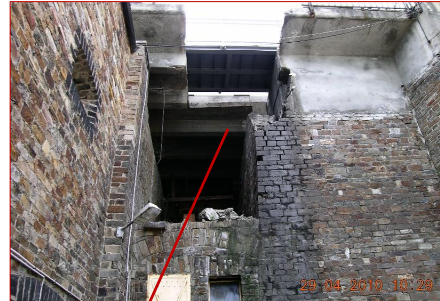
Teileinsturz 2008 und Provisorium
